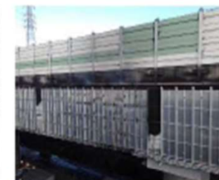
写真5 足場の損傷状況[側面から]
