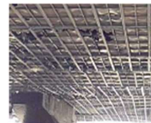
写真4 足場の損傷状況[下面から]
