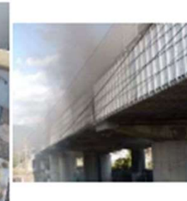
写真3 火災状況 [本線外から]
