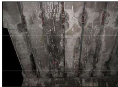
(a) ひび割れ発生状況
