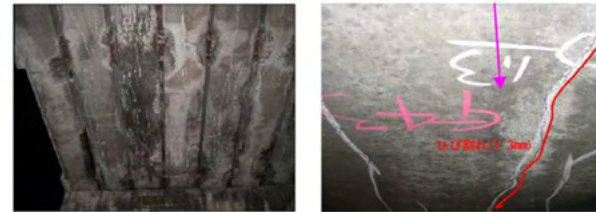
(a) ひび割れ発生状況 (b) ひび割れ部の拡大
