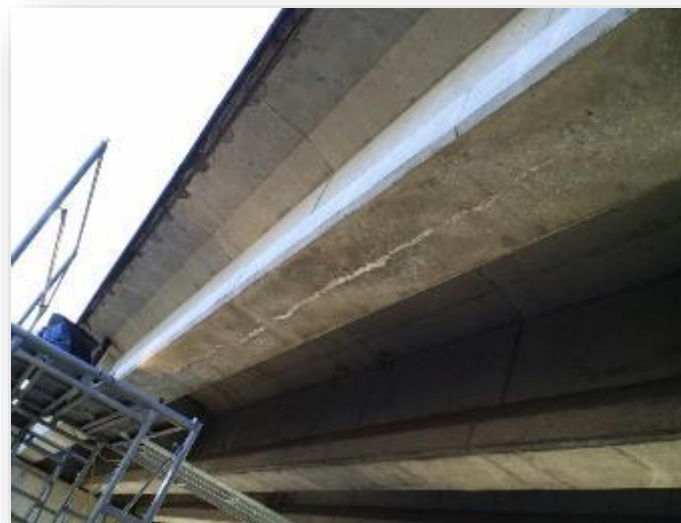
ポストテンション方式T桁の下フランジに生じたひび割れの事例
