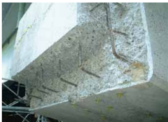
図 2-34 ASR による鉄筋破断
