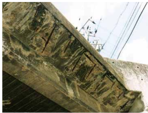
図 2-18 張出し床版下面の鉄筋露出
