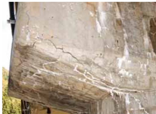
図 2-28 ASR による劣化
