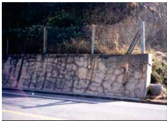
図 2-30 擁壁のひび割れ
