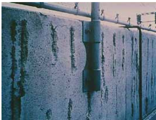
図 2-17 壁高欄のコンクリート剥落
