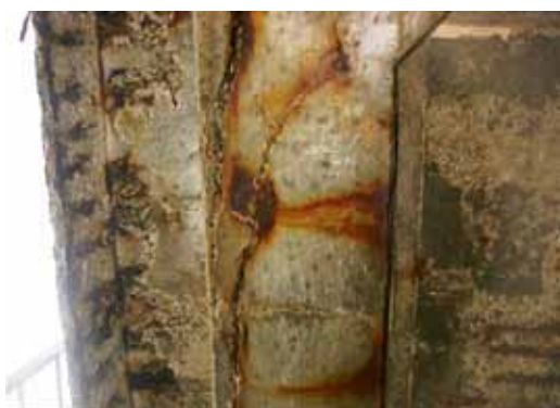
図 2-3 床版下面のさび汁
