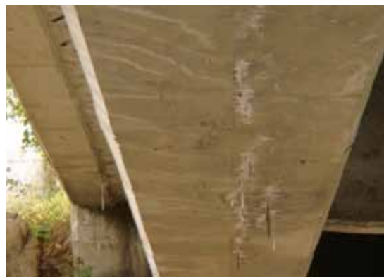
図 2-32 PC 桁下面のひび割れ
