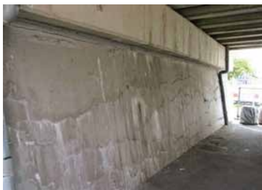
図 2-36 橋台の再劣化
