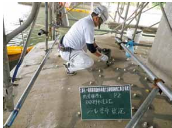
座金取付、ひび割れシール状況
