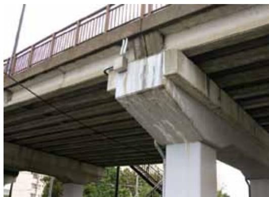
図 2-35 橋脚はり部の再劣化
