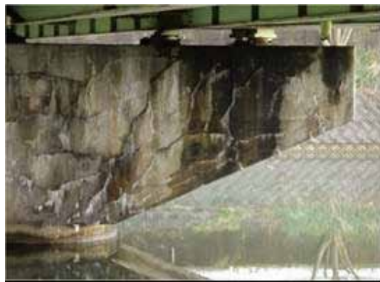
図 2-31 橋脚はり部のひび割れ
