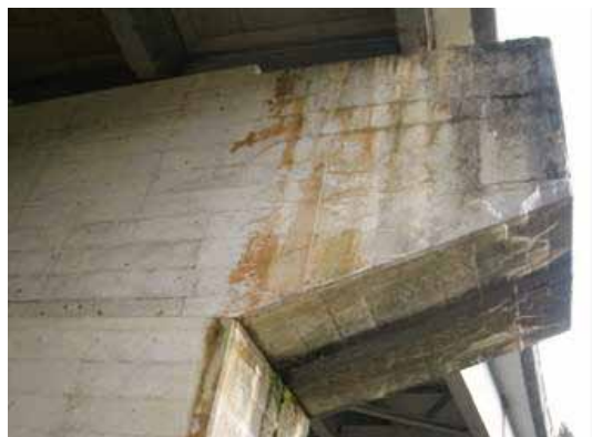
図 2-33 部位によるひび割れの状況
