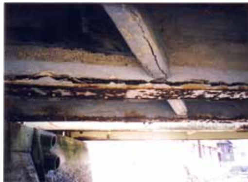
図 2-6 補修箇所の再劣化
