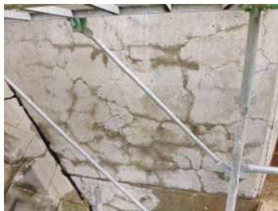
施工前の劣化状況
