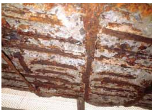
図 2-5 主桁下面の鉄筋腐食
