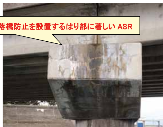
施工前の劣化状況
