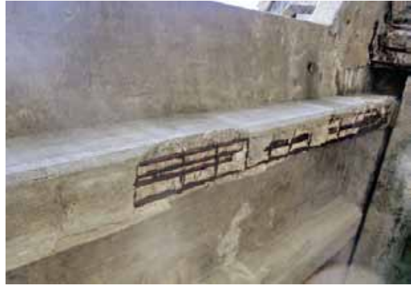
図 2-1 塩害による劣化の例
