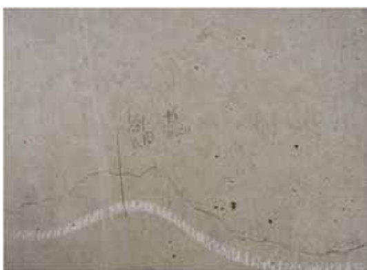
図 2-37 RC 巻立て後の再劣化
