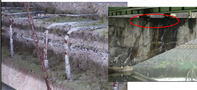
ASRによる鉄筋破断の事例(橋脚はり上縁側鉄筋曲げ加工部)
