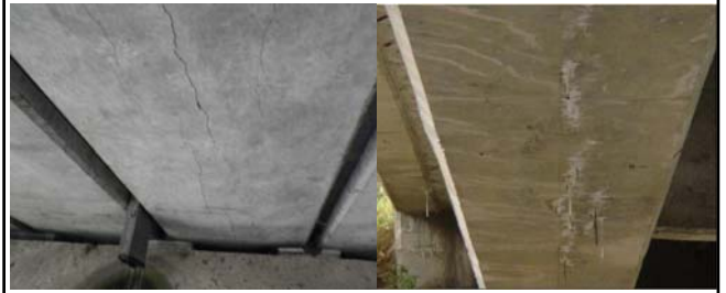
上部工(RC桁、PC桁)のASR劣化事例
