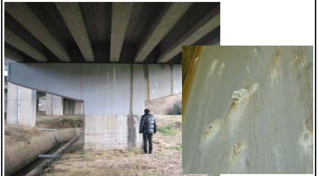
橋脚のASR再劣化事例(塗膜を剥がしてみると…)
