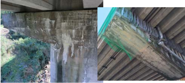
橋台のASR劣化事例
