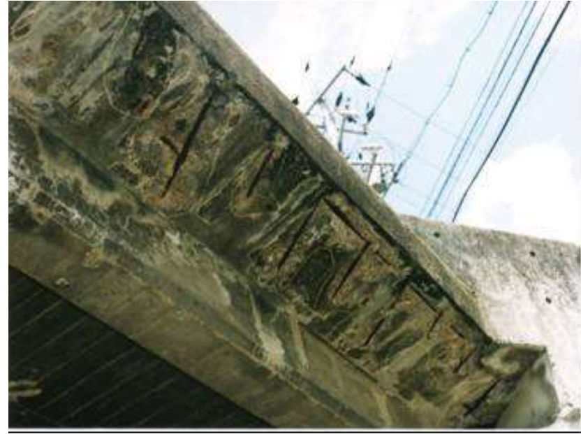
張出し床版下面の鉄筋露出
